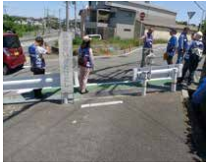
劣化した看板とレールの隙間
