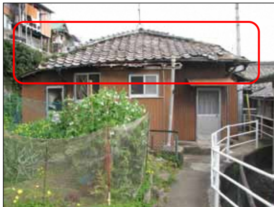
屋根に不陸がある例
