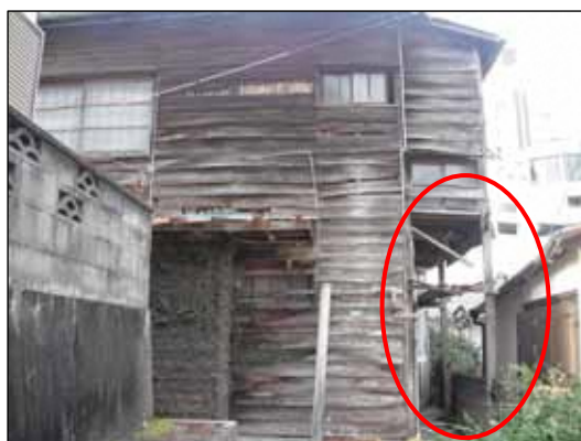
柱の数箇所に破損がある例
