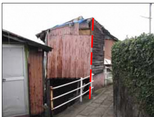
一部の柱が傾斜している例
