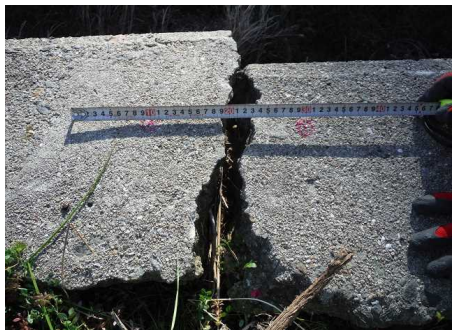
④ブロック積天端のズレ
