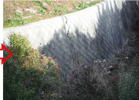
②ブロック積のズレ(遠景)
