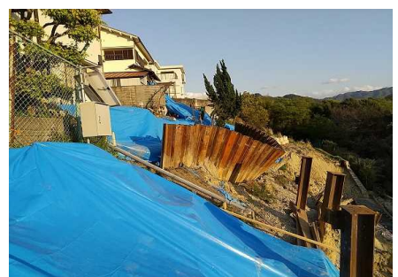
令和2年4月24日 土留鋼矢板傾き状況
