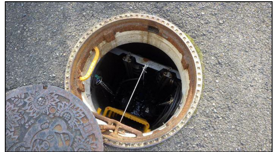
マンホール内のポンプ施設
