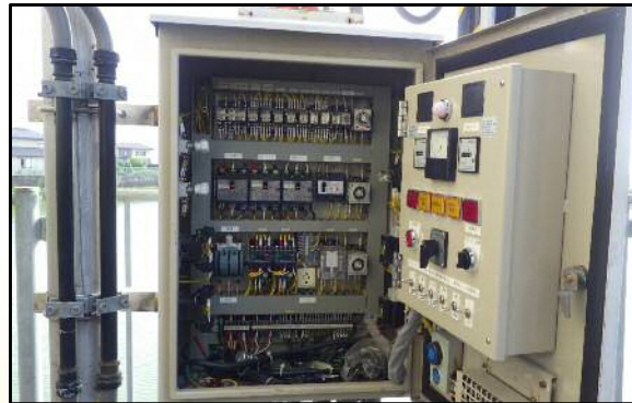
制御盤の内部
