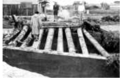
図39 集中豪雨による向田橋の被害状況（昭和27年）
