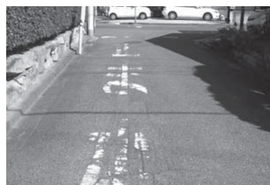
消えかかっている路面表示
