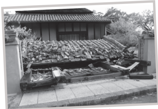
▲台風第21号による被害(中家住宅)
