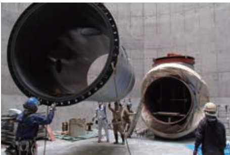
事故時におけるバックアップ機能の向上（バイパス送水管の整備）
